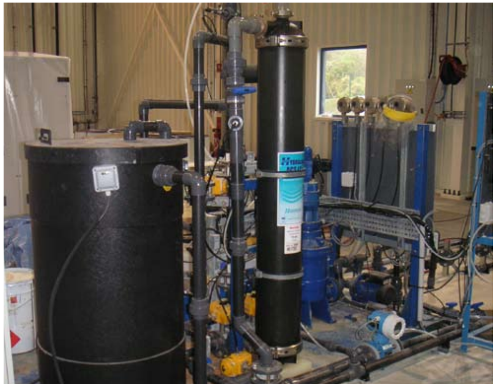
Pilote OPALINE à base de membranes d'ultrafiltration couplées à du charbon actif ou de la résine
